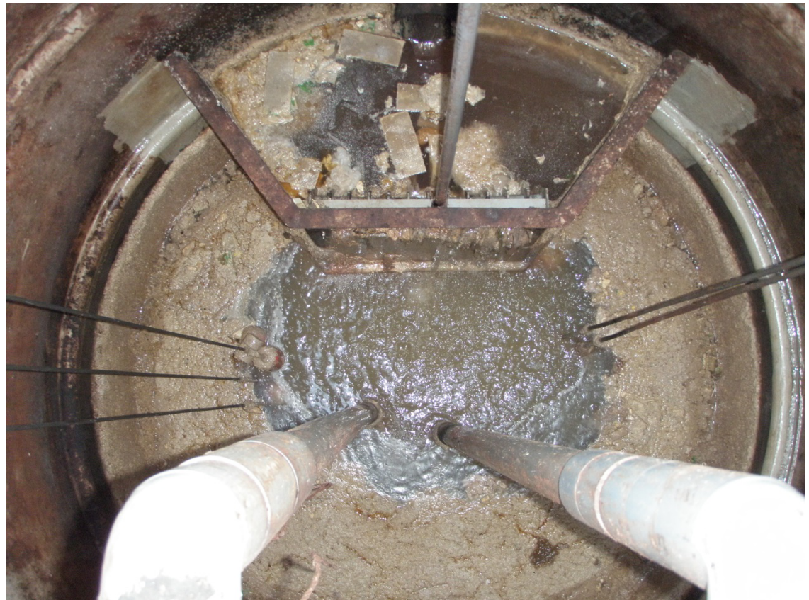
(原水ポンプ槽)
