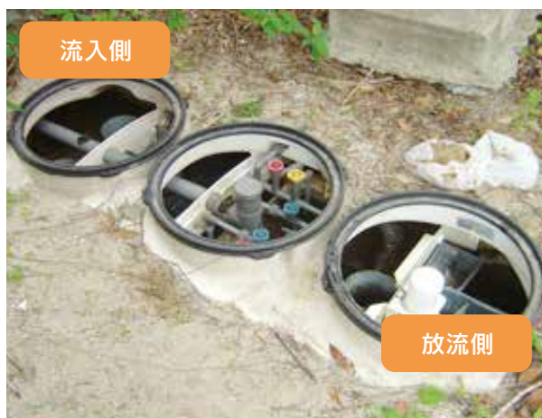
浄化槽上部のようす (放流側が沈下)
